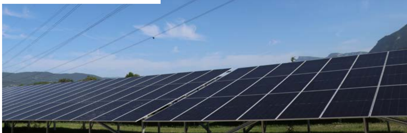
Centrale photovoltaïque Alp'Cœur Énergie
