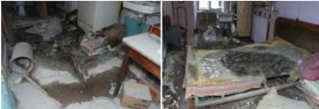
Du mobilier et des rebuts chargent les planchers et maintiennent l'humidité
